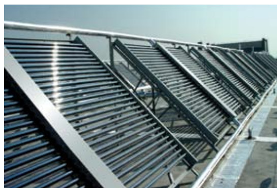
Collettore VSD Double wing (versione per tetto piano)
